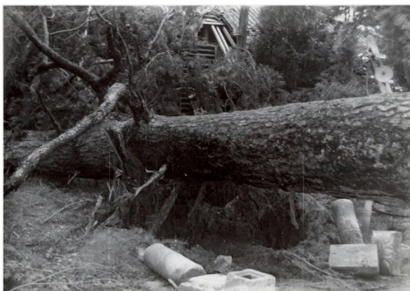
1200年来の手向山八幡宮校倉の破壊箇所と倒木下樹木
